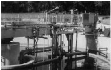
Räumerrücke im Nachklärbecken mit Schwimmschlammabläumung
