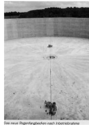
Das neue Regenfangbecken nach Inbetriebnahme
